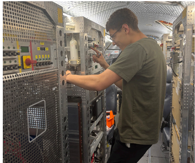
William Schenk montiert die Rohrleitungen für einen Aerosoleinlass, über den bei wolkenfreiem Himmel Aerosolpartikel erfasst werden.
