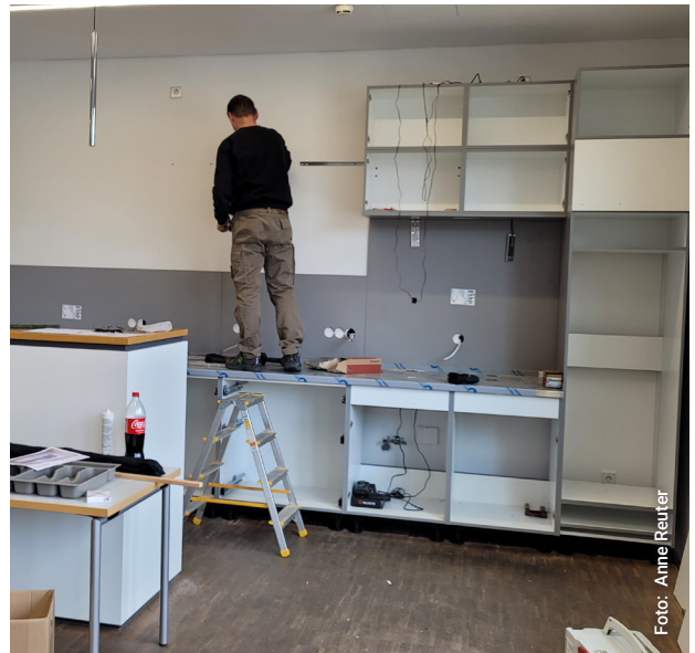
Einbau der neuen Küche im Seminarraumbereich startete pünktlich. Installation of the new kitchen in the seminar room area started on time.
