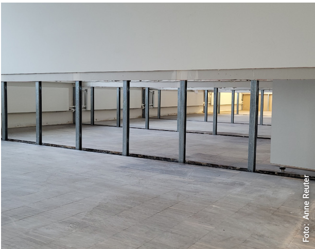
Freier Durchblick in die Nachbarbüros: Die feuchten Wände mussten 50 cm hoch abgebaut werden. | Unobstructed view into the neighboring offices: The damp walls had to be dismantled up to a height of 50 centimeters.
